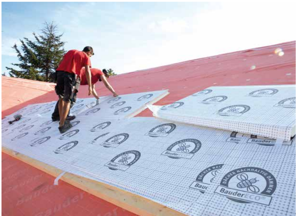
Über alte Dächer geht viel Heizenergie verloren. Eine Sanierung mit Wärmedämmung senkt die laufenden Kosten und steigert den Wohnkomfort. Foto: djd/Paul Bauder/Michael Hauler
