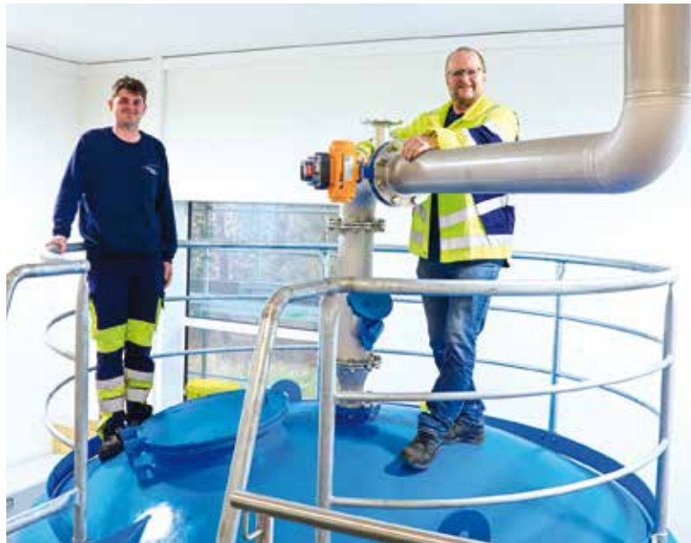
Wassermeister George Irving und Frank Gläser (v.l.) in der neuen Filterhalle am Wasserwerk Wagenfeld. Foto: Stadtwerke Huntetal
